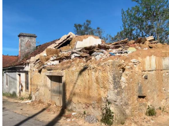
Figura 5: Imóvel degradado e devoluto na rua do Vale
