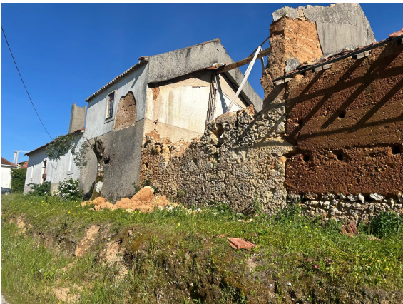
Figura 2: Imóvel degradado na travessa da Bela Vista
